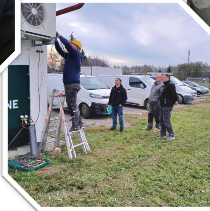
INSTALATER GRIJANJA I KLIMATIZACIJE
